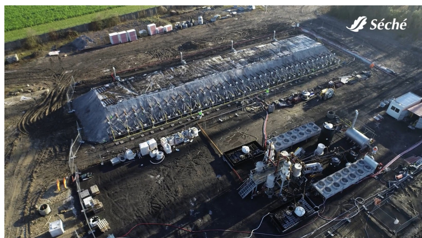
Proyecto de Harnes: Vista general de la Termopila
