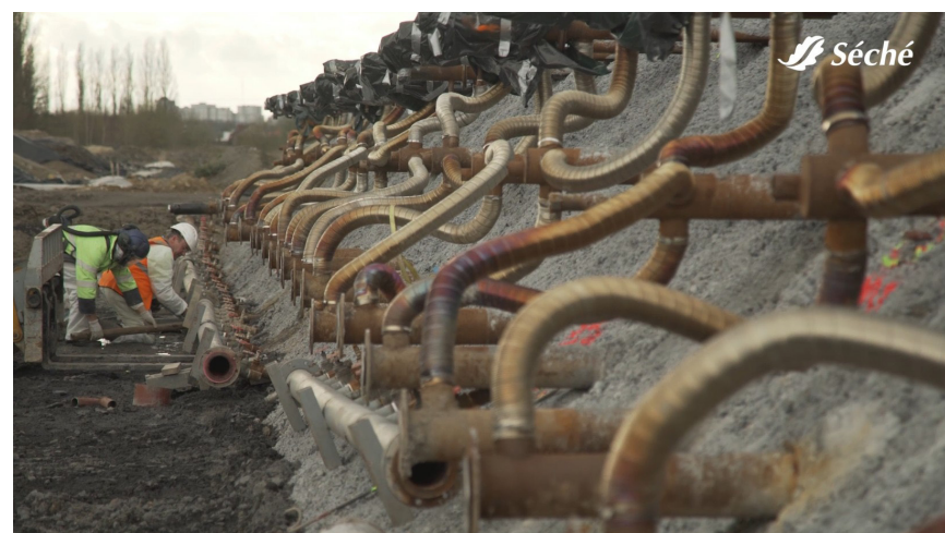
Proyecto de Harnes: Red de inyección de calor a la termopila.
